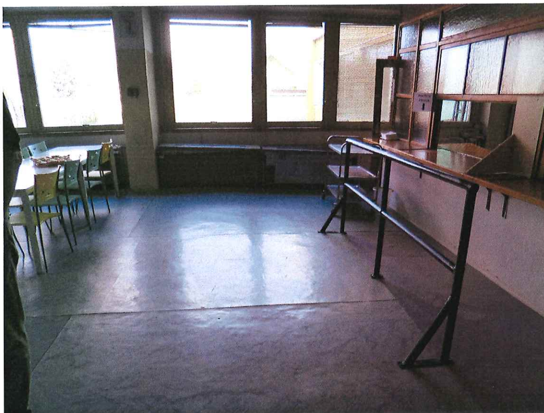
3/ DEFORMOVANÁ PODLAHA V JEDÁLNI -VYÚSTENIE KANALIZÁCIE
