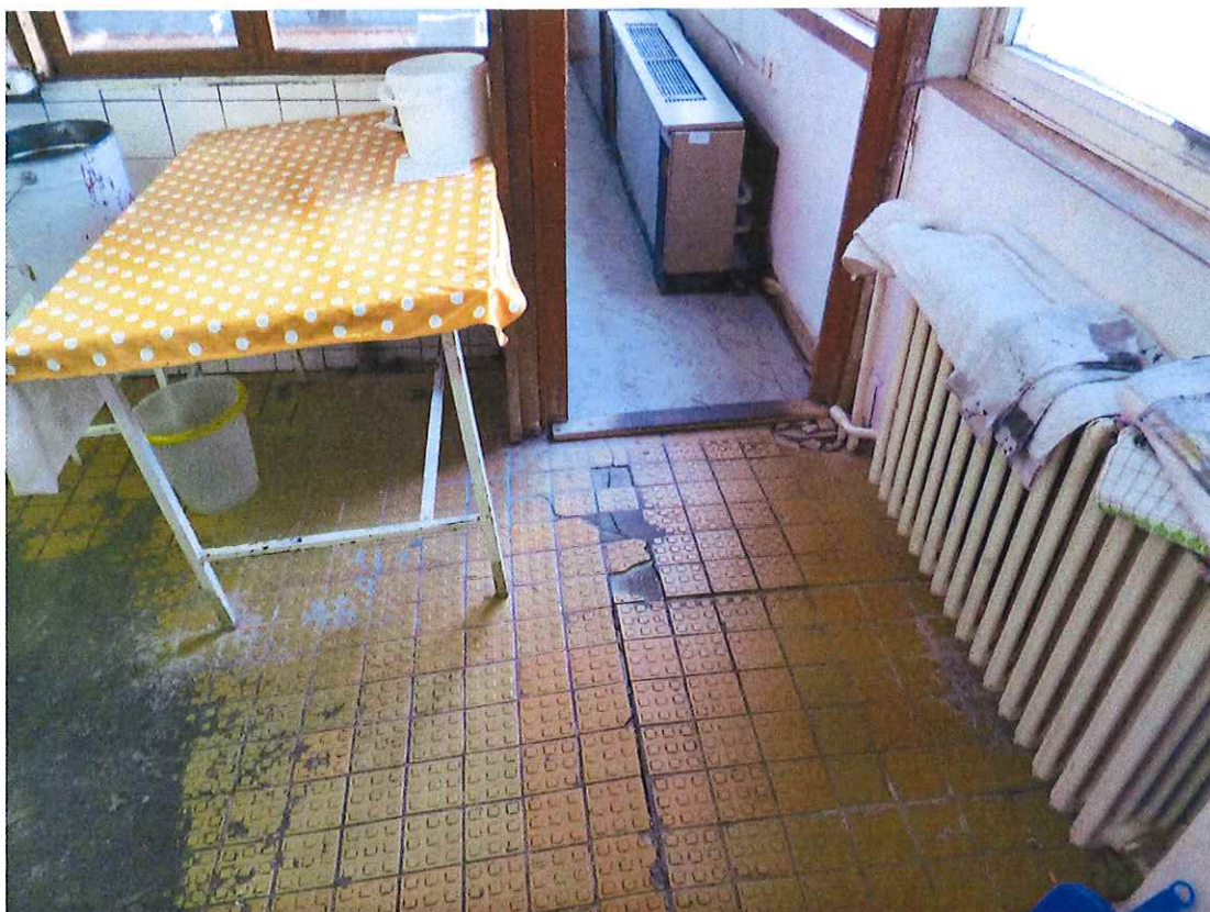
7/ DETAIL - DEFORMOVANÁ PODLAHA /KUCHYŇA - JEDÁLEŇ/
