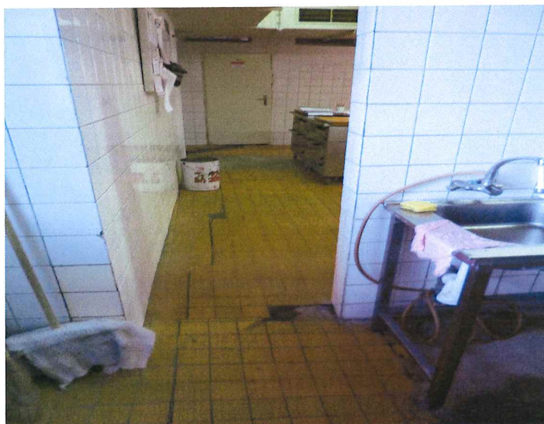
4/ DEFORMOVANÁ A PORUŠENÁ PODLAHA V KUCHYNI
