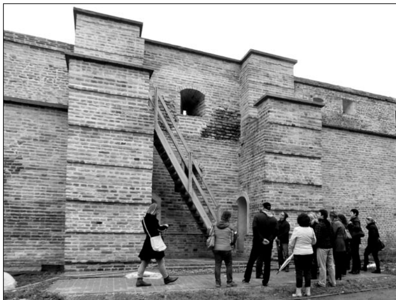
V rámci projektu Spoznajme naše mestá – Trnava a Břeclav, ktorého cieľom je podporiť zážitkovú turistiku medzi našimi partnerskými mestami, sa uskutočnila rekonštrukcia veže mestského opevnenia medzi Jerichovou a Hornopotočnou, ktorá sa stane súčasťou turistického okruhu historickým centrom. V októbri 2014 navštívili naše mesto prví hostia z Břeclavi.
