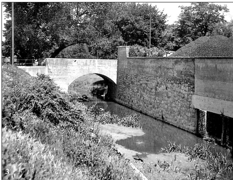
Tehlový most ku kalvárii a odklon časti toku potoka do areálu cukrovaru
