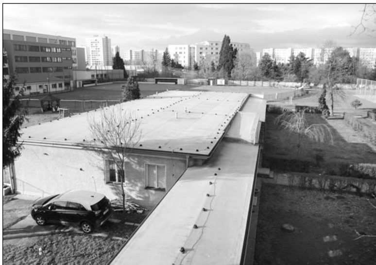
Nová kuchyňa s jedálňou bude postavená na mieste tohto pavilónu školy na Bottovej ulici
